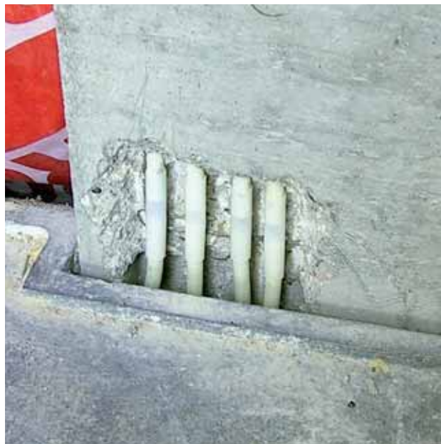
Figur 40. Rørføring mellem 2 elementer i en trapperums-væg ud for etageadskillelsen. Rørføringen, som er udført med flexrør, er delvis skjult af trappereposen. Den udsparring, der har været ved rørenes udmunding har tydeligvis ikke været stor nok. Det har været nødvendigt at hugge yderligere ud omkring rørene. Det vil kræve stor omhu at lave en pæn udstøbning omkring rørene bag reposen.
