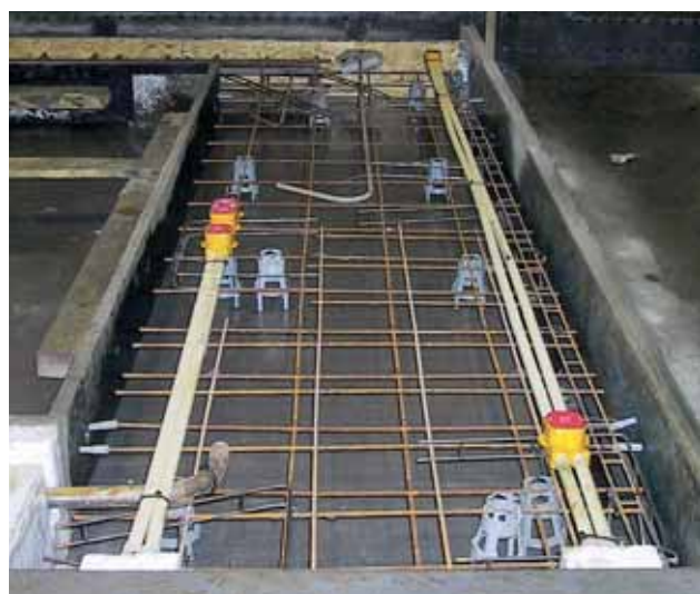
Figur 26. El-indstøbning i opsidens af et betonelement. De el-rør og dåser, som skal ligge i opsidens af et betonelement, ilægges oftest inden udstøbning. Indstøbningsdelene opløses på armeringen og fastholdes hertil. Elementet er set nedefra. I det færdige byggeri sker kabel-/rørføring i gulvet.
